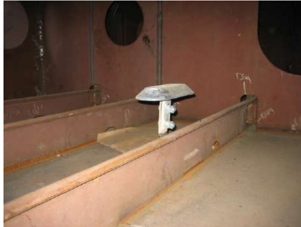
Resim 2.1: Balast tankının tuty ile katodik korunması
